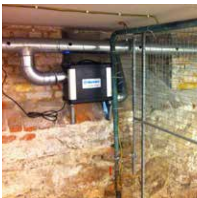
Kjellere og bodanlegg
