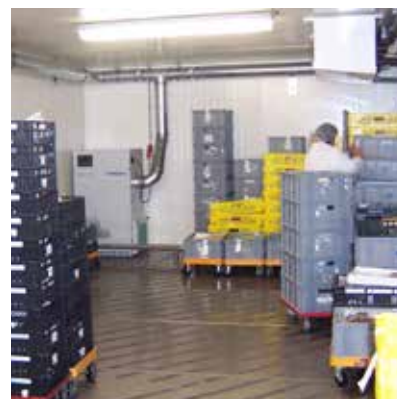
Kjøle- og fryselager
