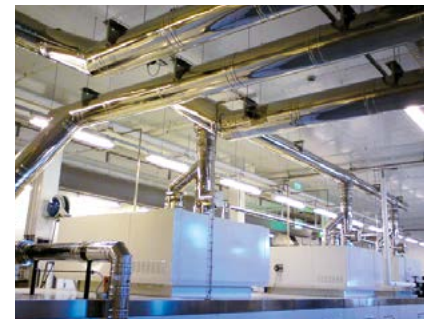
Røykgassavtrekk i næringsmiddelindustrien
